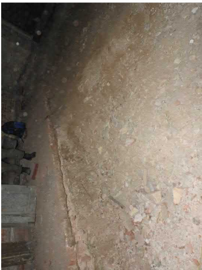
1101-F03: Situace sondy 1101 před vybíráním zásypu klenby; foceno od severozápadu; fotil Ditmar E.; datum 27.4.2020
