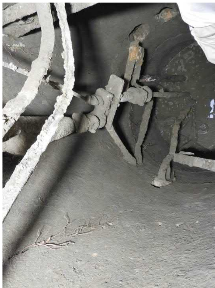
501-F34: Železná konstrukce a součásti čerpadla ve studni Z050; foceno od severovýchodu; fotil Ditmar E.; datum 17.6.2020
