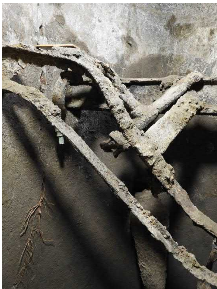
501-F35: Železná konstrukce a součásti čerpadla ve studni Z050; foceno od východu; fotil Ditmar E.; datum 17.6.2020
