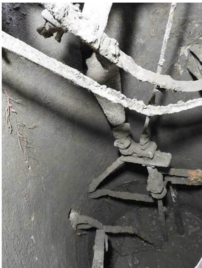
501-F51: Železná konstrukce a součásti čerpadla ve studni Z050; foceno od severovýchodu; fotil Ditmar E.; datum 17.6.2020
