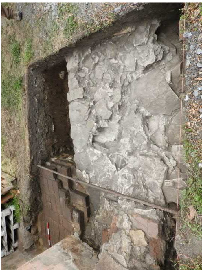
701-F13: Zdi Z01a, Z03a, Z05; foceno od západu; fotil Ditmar E.; datum 29.4.2020
