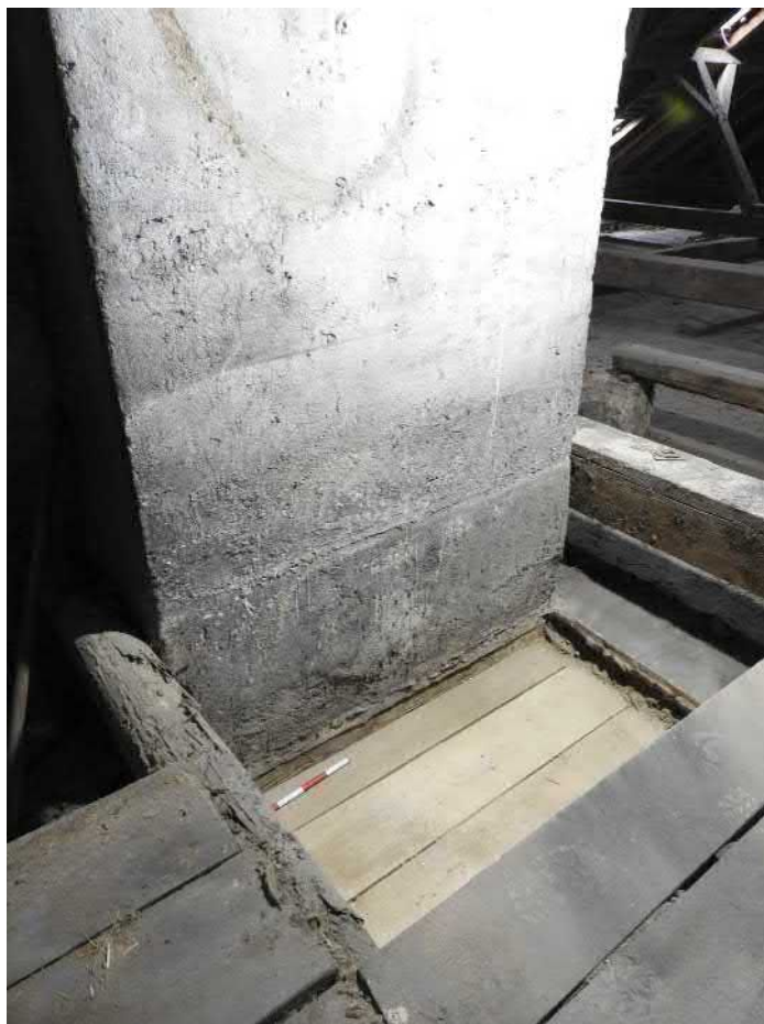
1405-F02: Sonda 1405 po odstranění cihlové dlažby; foceno od jihozápadu; fotil Ditmar E.; datum 25.5.2020
