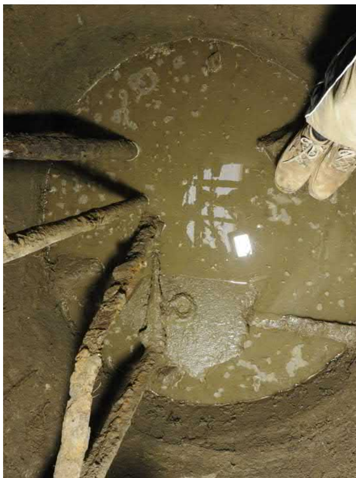
501-F50: Železná konstrukce a součásti čerpadla ve studni Z050; foceno od severovýchodu; fotil Ditmar E.; datum 17.6.2020
