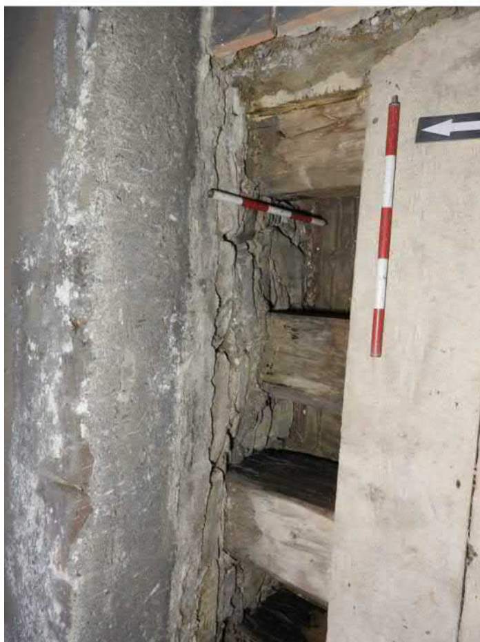
1402-F04: Stropní a podlahové trámy v sondě 1402; foceno od jihu; fotil Ditmar E.; datum 14.5.2020
