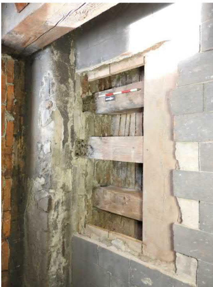
1404-F03: Stropní a podlahové trámy v sondě 1404; foceno od severu; fotil Ditmar E.; datum 26.5.2020
