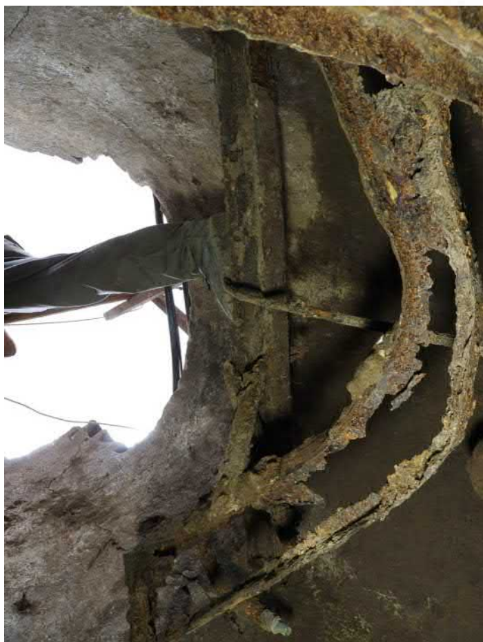
501-F49: Železná konstrukce a součásti čerpadla ve studni Z050; foceno od západu; fotil Ditmar E.; datum 17.6.2020
