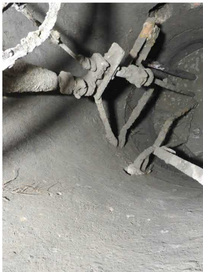
501-F36: Železná konstrukce a součásti čerpadla ve studni Z050; foceno od severovýchodu; fotil Ditmar E.; datum 17.6.2020
