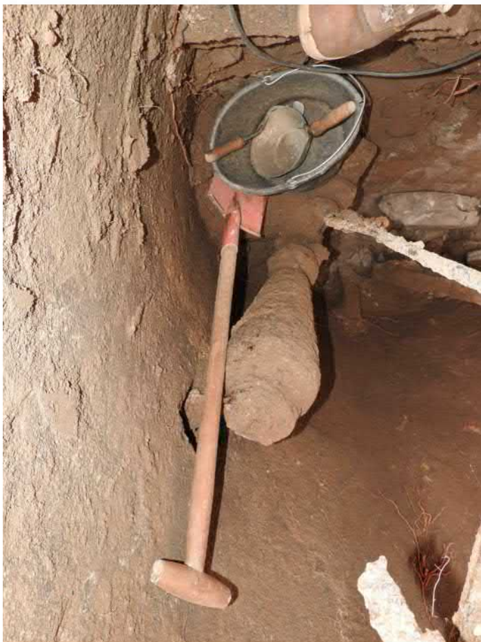
501-F29: Železné konstrukce a součásti čerpadla ve studni Z050; foceno od západu; fotil Ditmar E.; datum 15.6.2020
