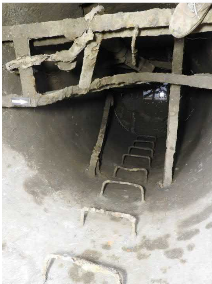
501-F32: Železné konstrukce a součásti čerpadla ve studni Z050; foceno od severu; fotil Ditmar E.; datum 17.6.2020
