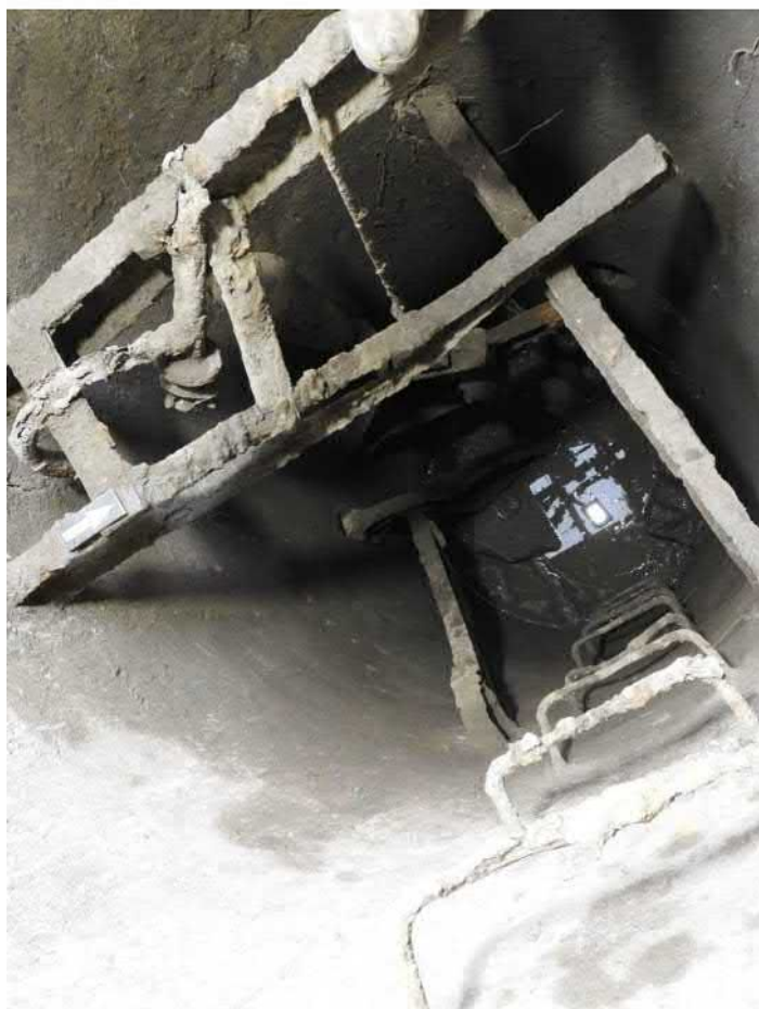
501-F33: Železná konstrukce a součásti čerpadla ve studni Z050; foceno od severovýchodu; fotil Ditmar E.; datum 17.6.2020
