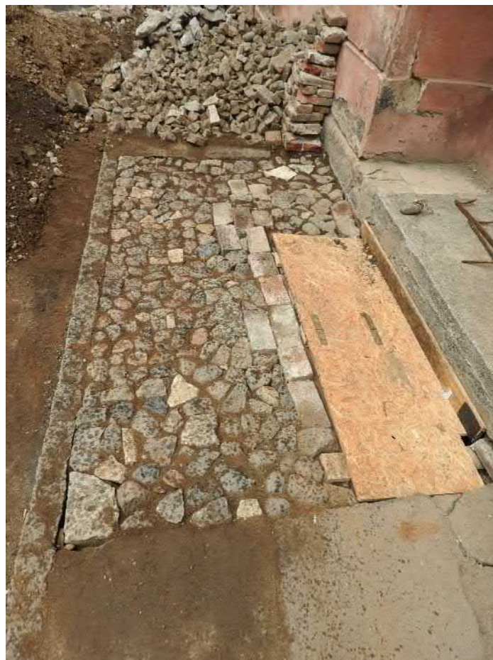
501-F86: Sonda po zasypání a provizorním zadláždění; foceno od jihu; fotil Ditmar E.; datum 24.6.2020
