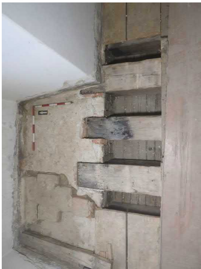
1301-F10: Stropní a podlahové trámy v sondě 1301; foceno od jihu; fotil Ditmar E.; datum 11.5.2020
