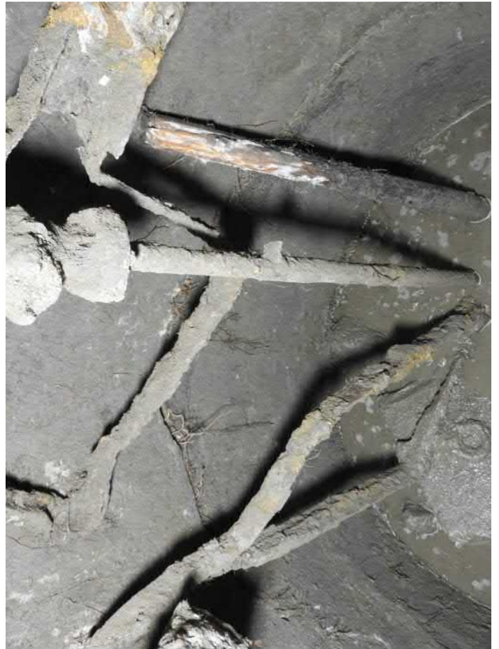
501-F46: Železná konstrukce a součásti čerpadla ve studni Z050; foceno od severovýchodu; fotil Ditmar E.; datum 17.6.2020
