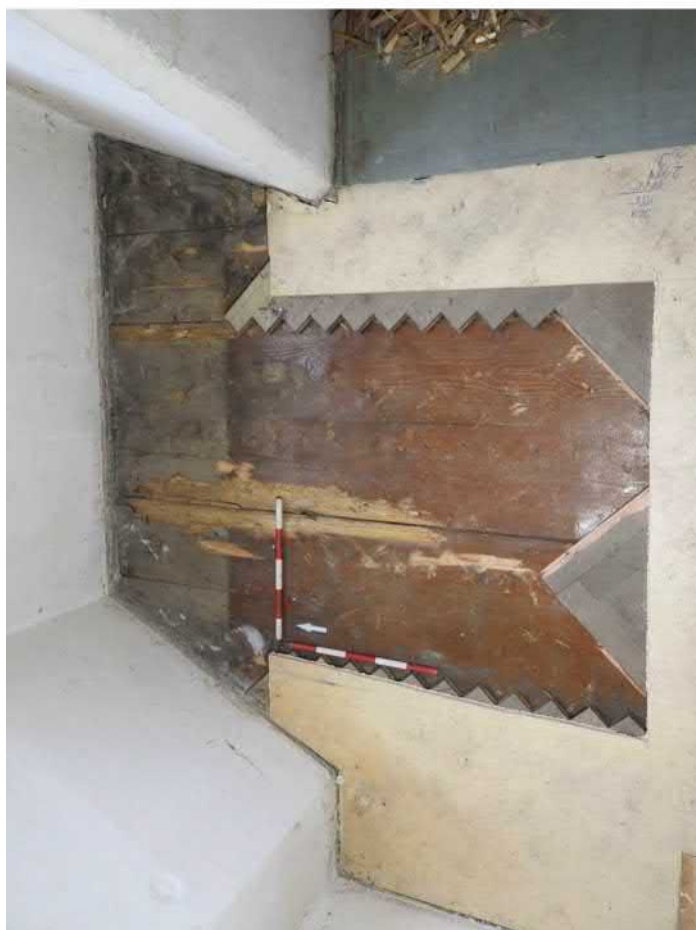
1203-F04: Sonda po odstranění parket vr. 1203-02; foceno od jihu; fotil Ditmar E.; datum 14.5.2020
