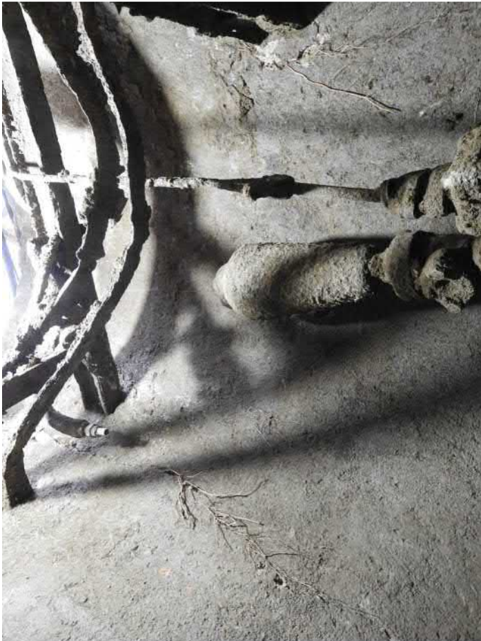
501-F45: Železná konstrukce a součásti čerpadla ve studni Z050; foceno od severovýchodu; fotil Ditmar E.; datum 17.6.2020
