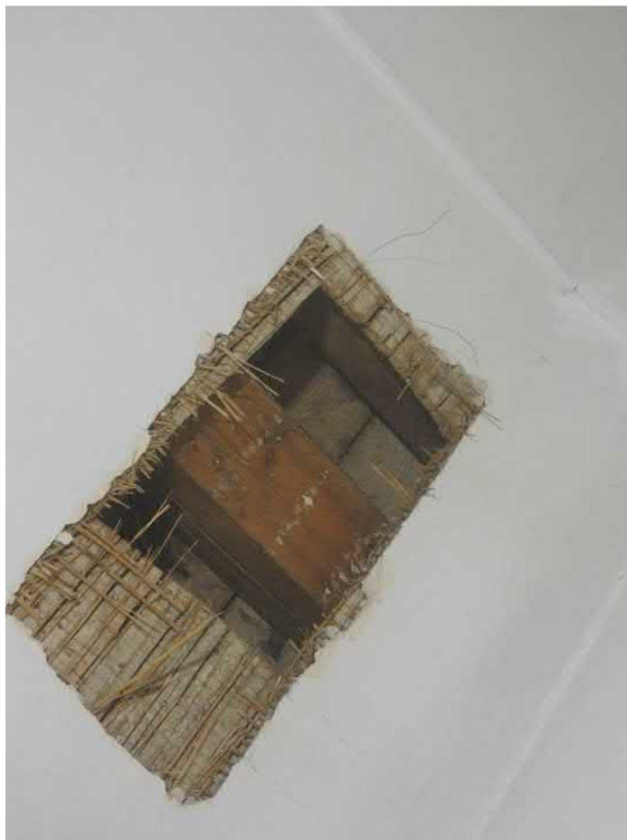
1310-F02: Stropní a podlahové trámy v sondě 1310; foceno od severovýchodu; fotil Ditmar E.; datum 8.6.2020
