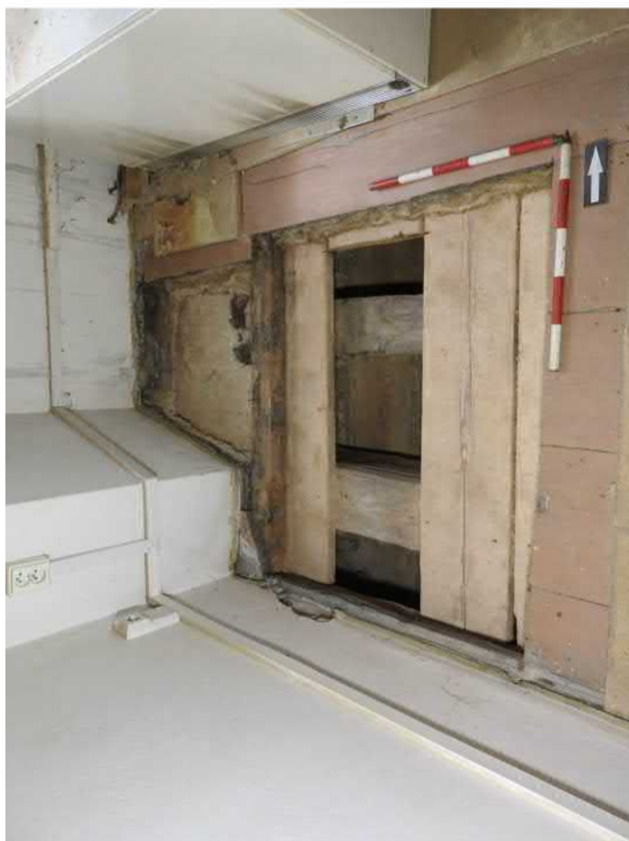
1307-F04: Stropní a podlahové trámy v sondě 1307; foceno od východu; fotil Ditmar E.; datum 20.5.2020
