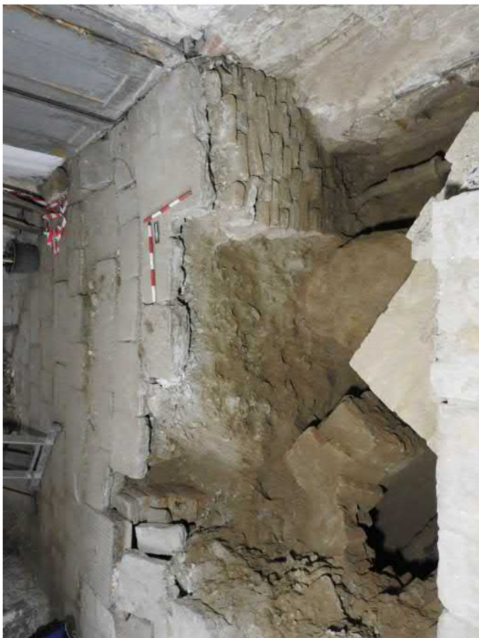
3101-F09: Zdi Z052, Z053, Z054, Z055; foceno od západu; fotil Ditmar E.; datum 10.6.2020
