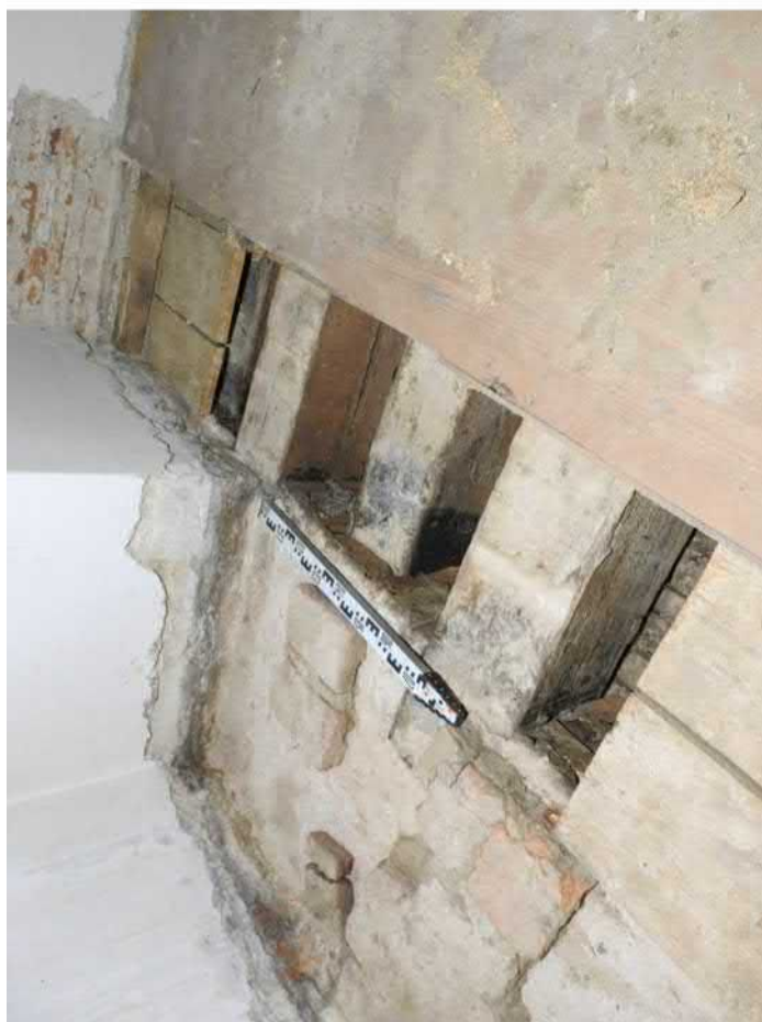
1301-F08: Stropní a podlahové trámy v sondě 1301; foceno od jihozápadu; fotil Ditmar E.; datum 11.5.2020
