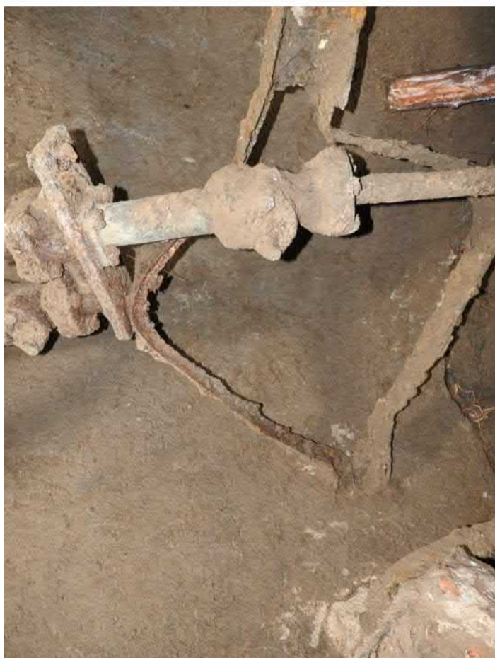
501-F39: Železné konstrukce a součásti čerpadla ve studni Z050; foceno od severovýchodu; fotil Ditmar E.; datum 17.6.2020
