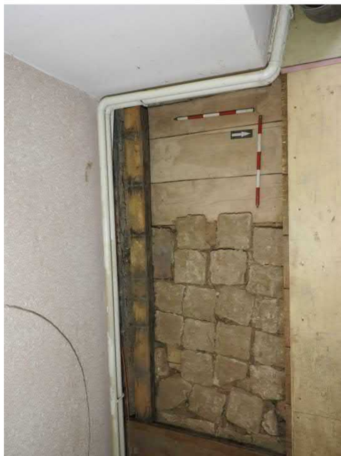
1305-F04: Sonda 1305 po odstranění části cihlových dlaždic; foceno od severu; fotil Ditmar E.; datum 20.5.2020
