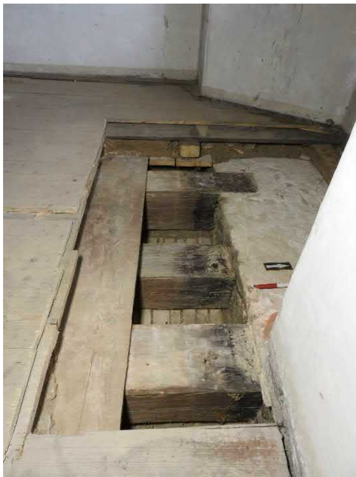
1303-F06: Stropní a podlahové trámy v sondě 1303; foceno od východu; fotil Ditmar E.; datum 14.5.2020
