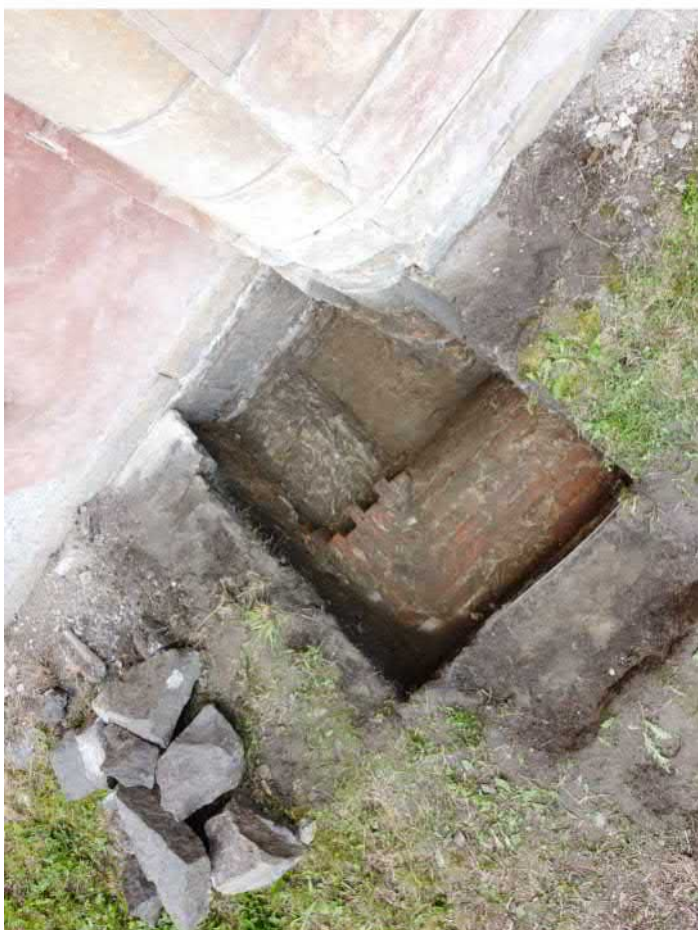
728-F11: Zdi Z65, Z67, Z68; foceno od severovýchodu; fotil Kalíšek M.; datum 17.6.2020
