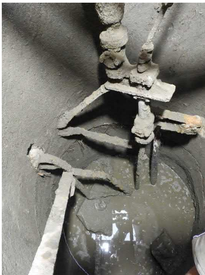
501-F52: Železná konstrukce a součásti čerpadla ve studni Z050; foceno od severovýchodu; fotil Ditmar E.; datum 17.6.2020
