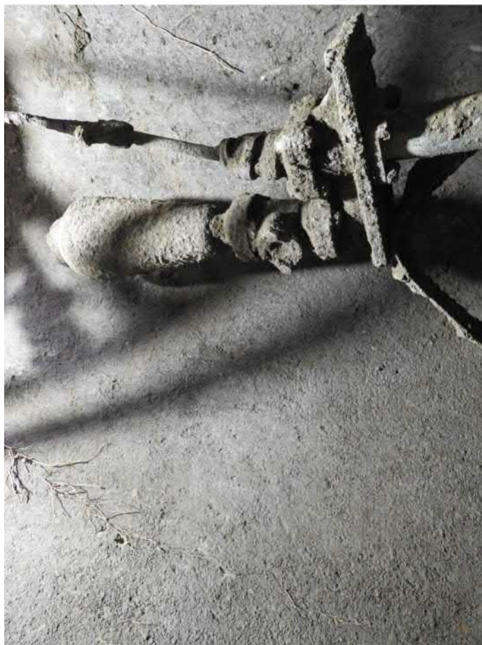
501-F44: Železná konstrukce a součásti čerpadla ve studni Z050; foceno od severovýchodu; fotil Ditmar E.; datum 17.6.2020
