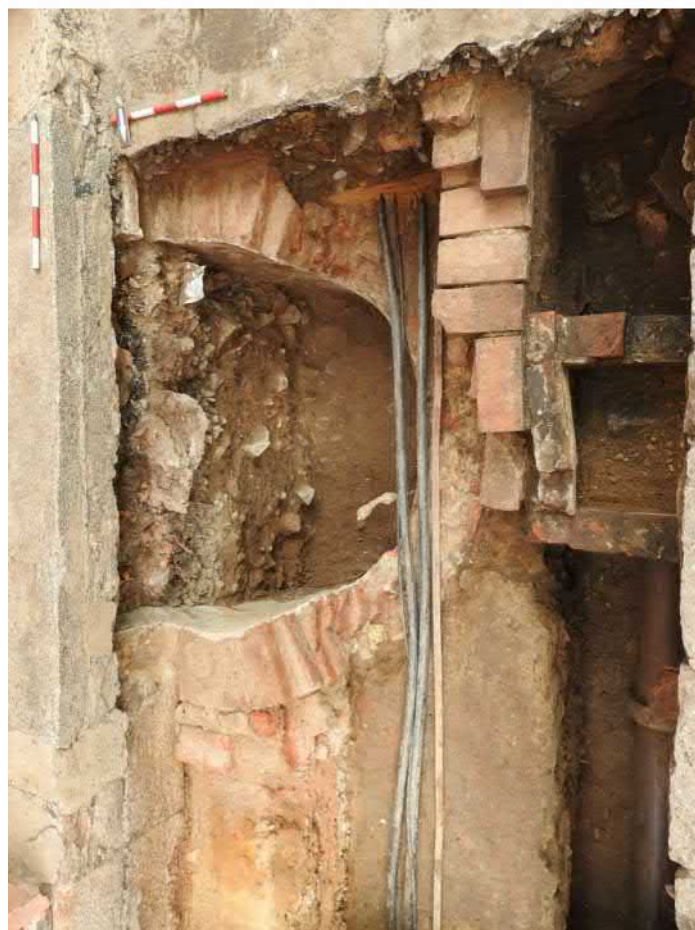
501-F18: Zdi Z048, Z049, Z050, Z051, výkopy V073, V074; foceno od západu; fotil Ditmar E.; datum 10.6.2020
