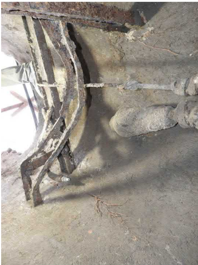
501-F41: Železná konstrukce a součásti čerpadla ve studni Z050; foceno od severovýchodu; fotil Ditmar E.; datum 17.6.2020
