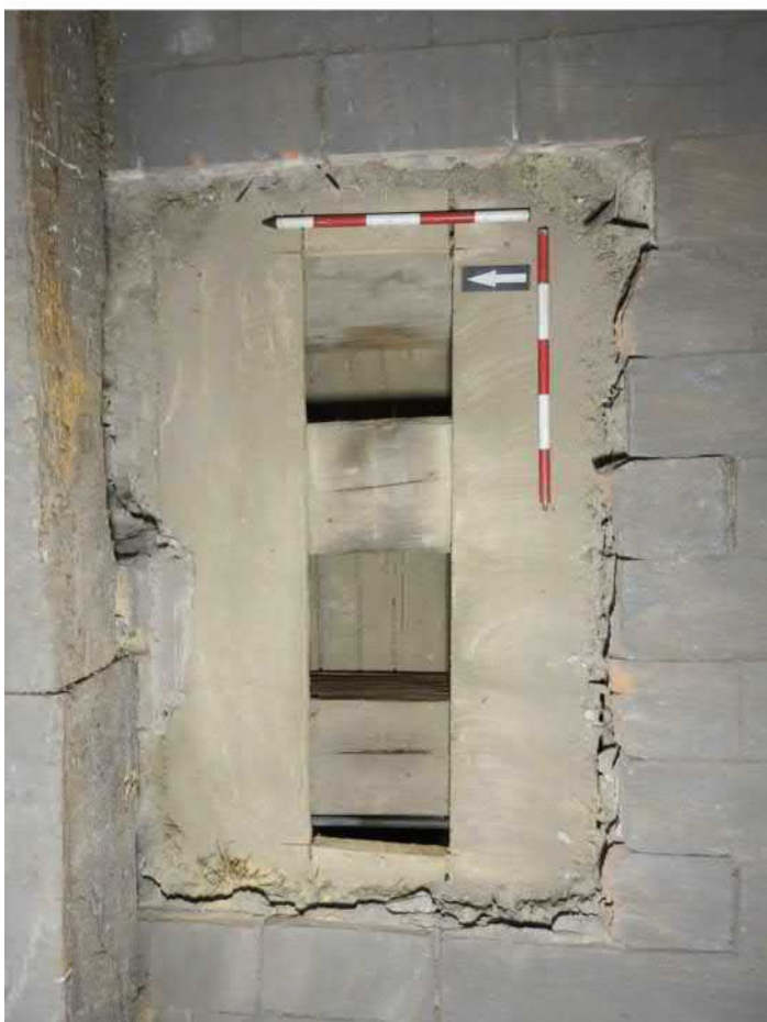
1408-F03: Stropní a podlahové trámy v sondě 1408; foceno od severu; fotil Ditmar E.; datum 18.6.2020
