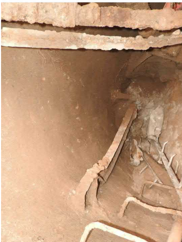
501-F27: Železné konstrukce a součásti čerpadla ve studni Z050; foceno od severu; fotil Ditmar E.; datum 15.6.2020
