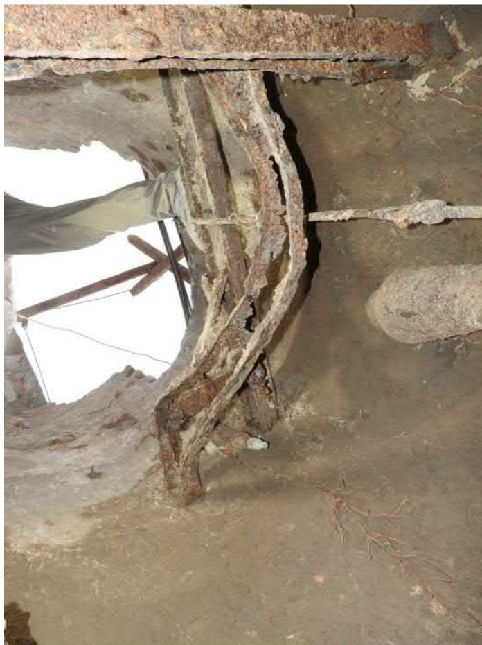
501-F42: Železná konstrukce a součásti čerpadla ve studni Z050; foceno od severovýchodu; fotil Ditmar E.; datum 17.6.2020
