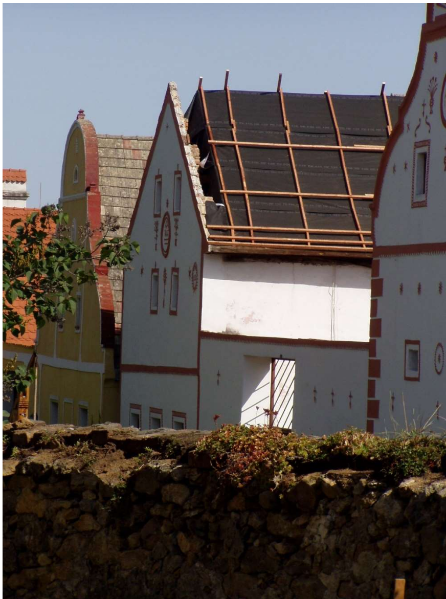
Holašovice, (okres České Budějovice), pohled na probíhající obnovu střechy obytného stavení usedlosti čp. 8 stojící na východní straně návsi, pohled od jihozápadu, (foto Michaela Špinarová, 2008)
