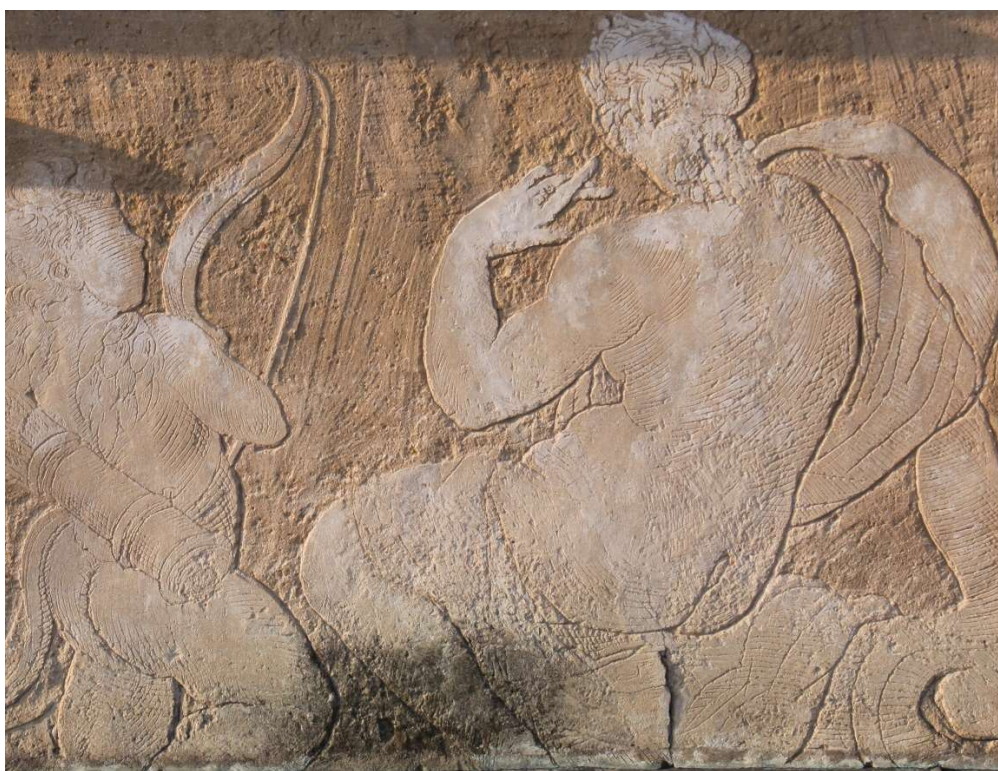
Zámek Litomyšl, štít východní fasády, detail pole 22IIP Venuše a Amor. V bočním osvětlení vyniká kvalita a velmi dobrý stav zachování sgrafita se zachovaným jemným rytím a trasologickými stopami. Ve spodní části rozvoj poškození odštěkující vodou (veškeré materiály E. Racková 2015, není-li uvedeno jinak).
