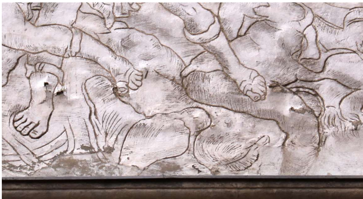
Zámek Litomyšl, fasáda 20. nádvoří, Samson bořící fílištínský chrám. Detail poškození spodní části pole před zajištěním v roce 2012 (foto E. Racková, 2011).
