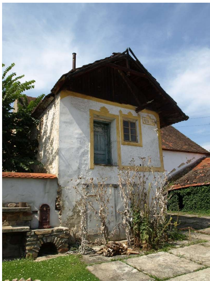
Holašovice, (okres České Budějovice), pohled od jihovýchodu na havarijní stav střechy čeledníku usedlosti čp. 19-38 situované na západní straně návsi (foto Michaela Špinarová, 2008)
