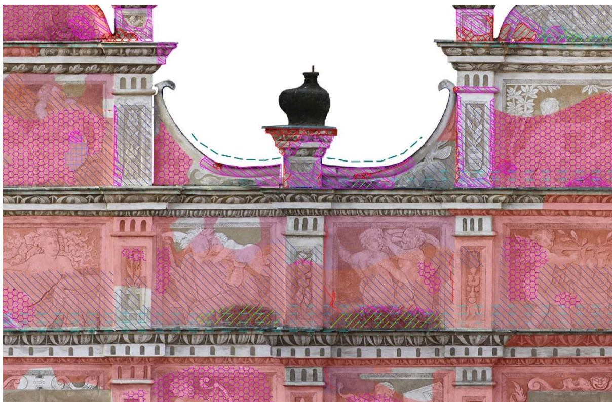
Zámek Litomyšl, severovýchodní fasáda. Figurální pole s rekonstruovanými horními částmi narušená stékáním vody ze štítů. Červeně podbarvené sgrafito z období stavby zámku do 1581, fialově druhotné ranně novověké, bez podbarvení novodobé. Zelenou šrafovou silně biotické napadení v místech dnešního zvlhčení nad oplechováním.
