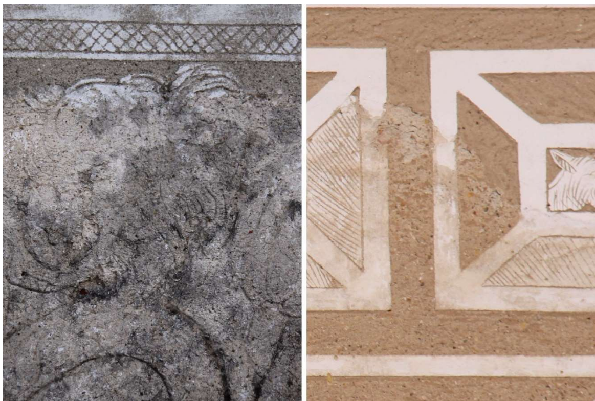
Zámek Litomyšl, detaily styku různých omítek. Vlevo: severní fasáda, pole 39IIP, dole renesanční omítka (neznámá fáze), nahoře novodobá. Vpravo: jižní fasáda, úsek pod otevřenou arkádou, nahoře omítka z roku 1983, dole předchozí provizorní oprava 1974 (obě fáze kolektiv Bošтік – Palcr – Podhrázský – Zoubek).
