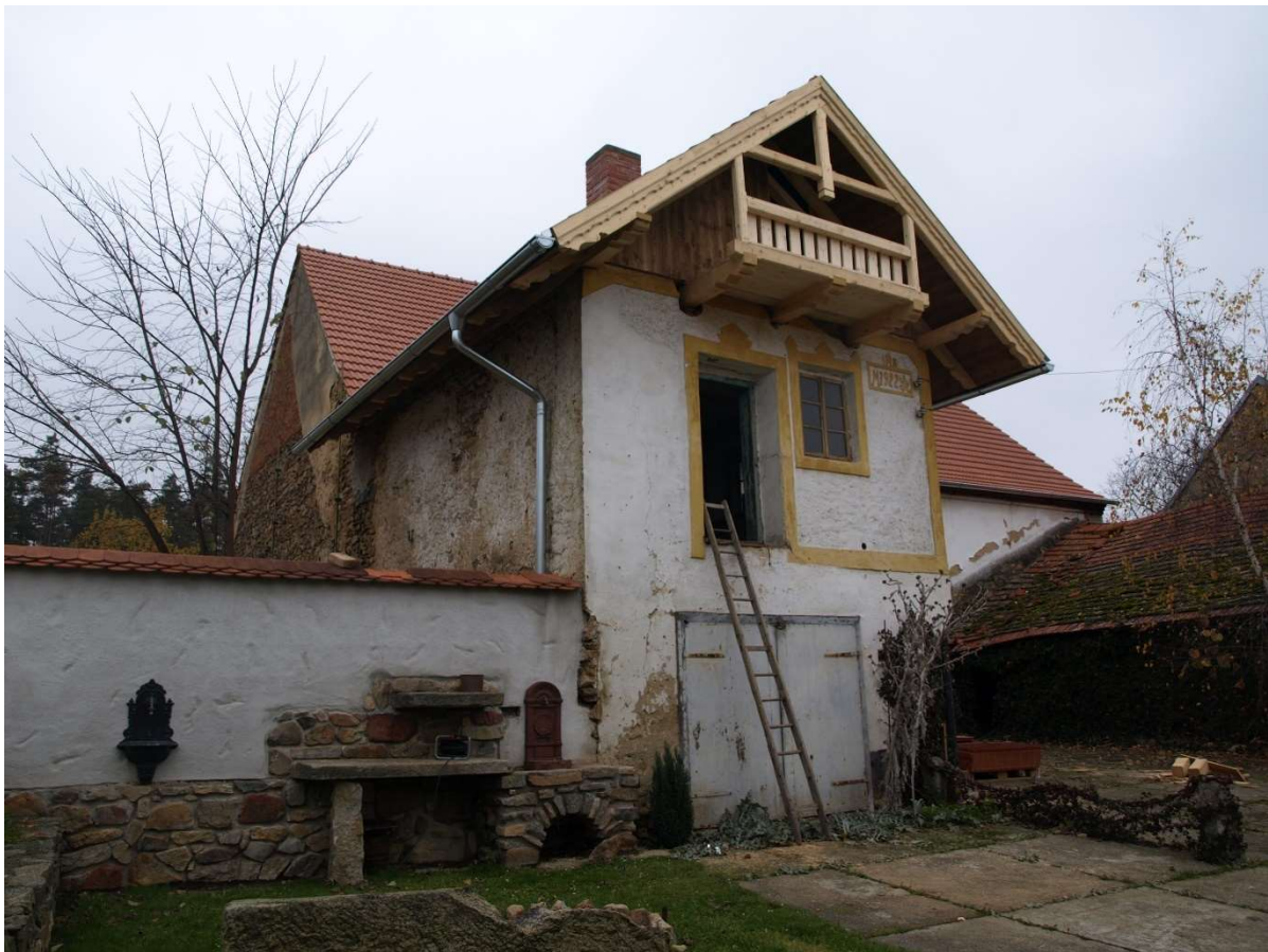
Hološovice, (okres České Budějovice), tentýž záběr na obnovenou střešní konstrukci včetně pavlače čeledníku usedlosti čp. 19-38, (foto Michaela Špinarová, 2009)
