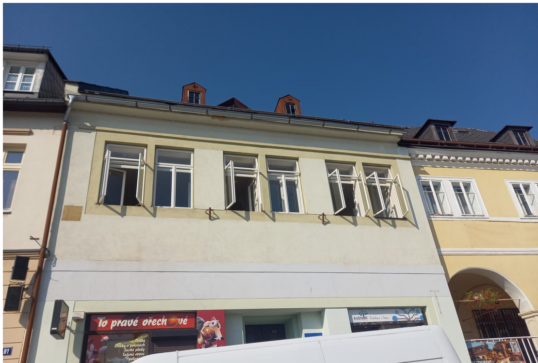
Pohled na východní (= hlavní domovní) průčelí domu čp. 80 – - z průběhu montáže (ustavená okna). Autor fotografie: Lukáš Stránský, Pila Novotný
