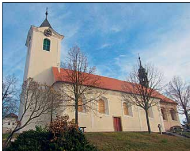
Kostelní Hlavno (správní obvod obce Brandýs nad Labem - Stará Boleslav), kostel sv. Petra v Okovech, oprava jižní fasády včetně nátěru (foto A. Švejdarová).
