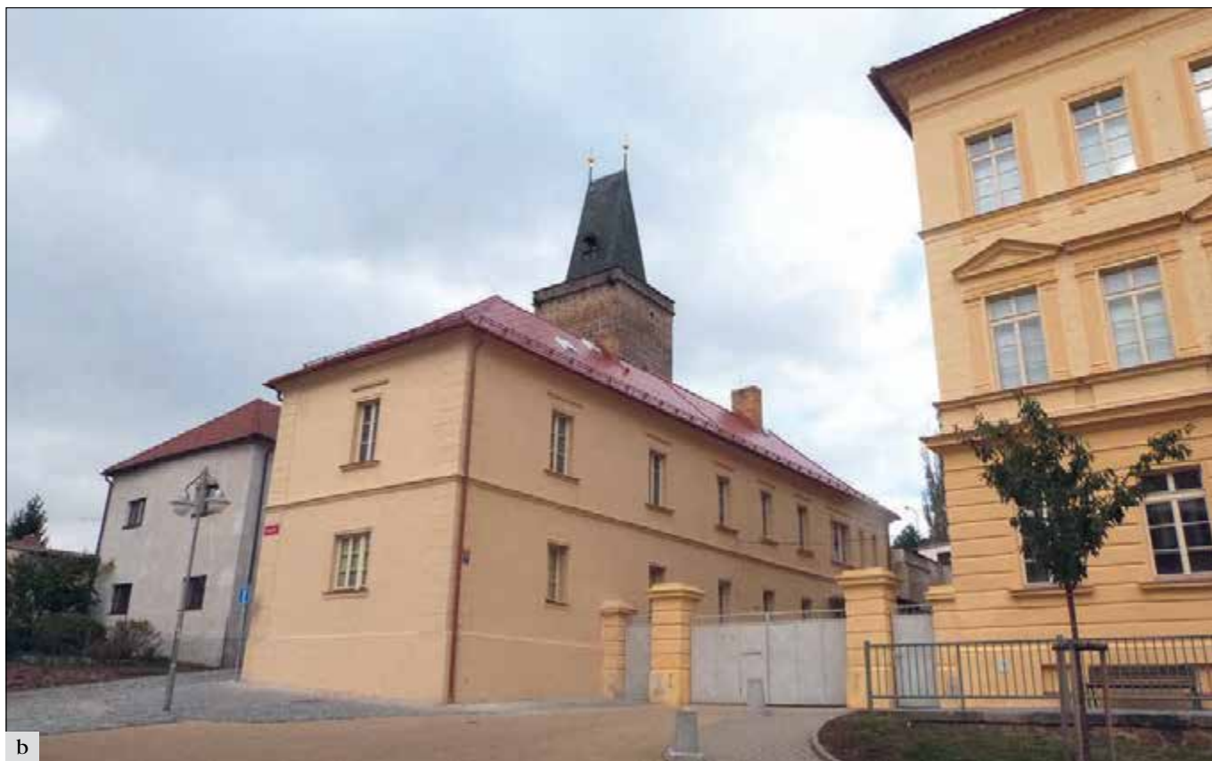
Rakovník (správní obvod obce Rakovník), MPZ, Kamenná ul. 152, dům tzv. Omáčkovny: a – nálezová situace na východní dvorní zdi po otlučení omítek a očištění; b – exteriér Omáčkovny od východu po dokončení oprav (foto E. Volfová).
