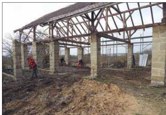
Mušský (správní obvod obce Mnichovo Hradiště), stodola usedlosti čp. 14, stav krátce po obnovení nosné pilířové konstrukce stodoly (foto J. Berková).
