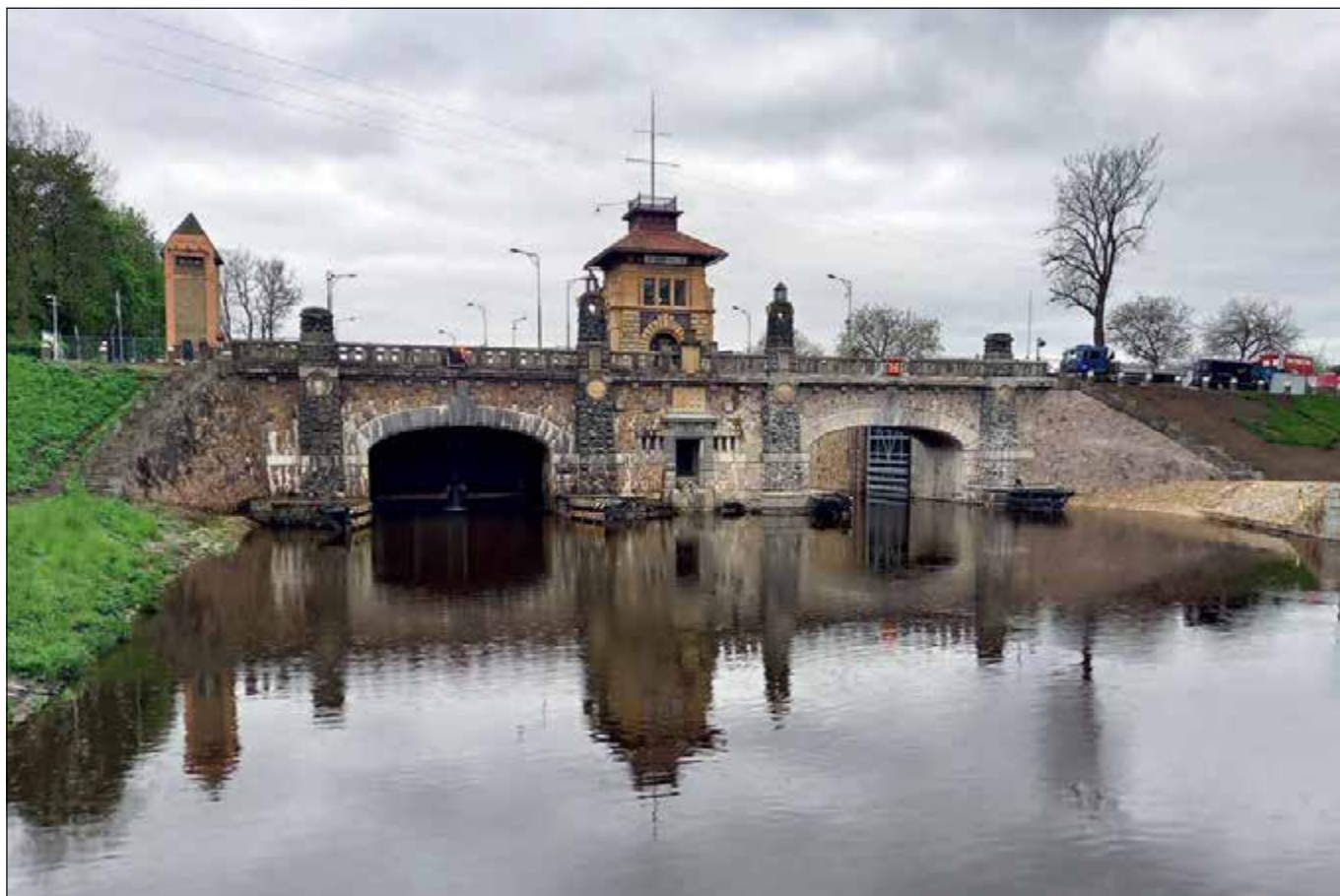
Hořín (správní obvod obce Mělník), zdymadlo vraňansko–hořínského plavebního kanálu, stav po dokončení prací, květen 2021 (foto O. Hrdlička).
