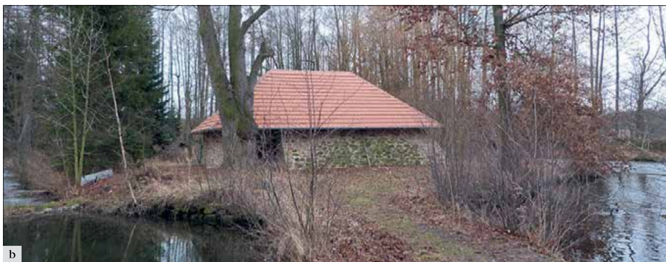
Pšovlky (správní obvod obce Rakovník), sklep na tvrzišti: a – stav obvodového zdiva nad zemí na začátku zednických oprav; b – dokončená oprava s valbovou střechou nad sklepem, krytou pálenými taškami bobrovkami (foto E. Volfová).
