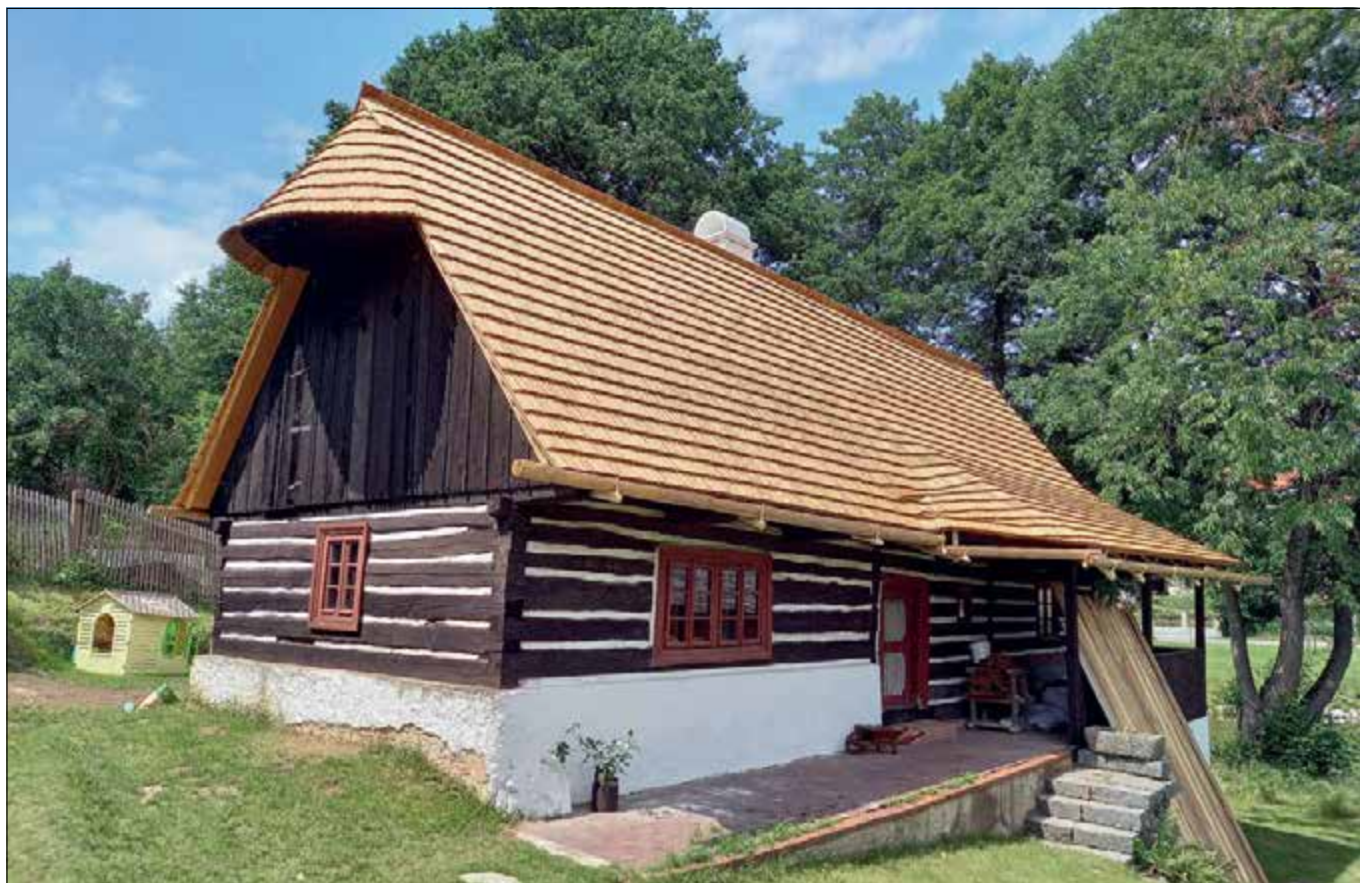
Nová Ves pod Pleší (okres Příbram), roubený dům čp. 18, probíhající obnova střešního pláště ze štípaného šindele (foto O. Hrdlička).
