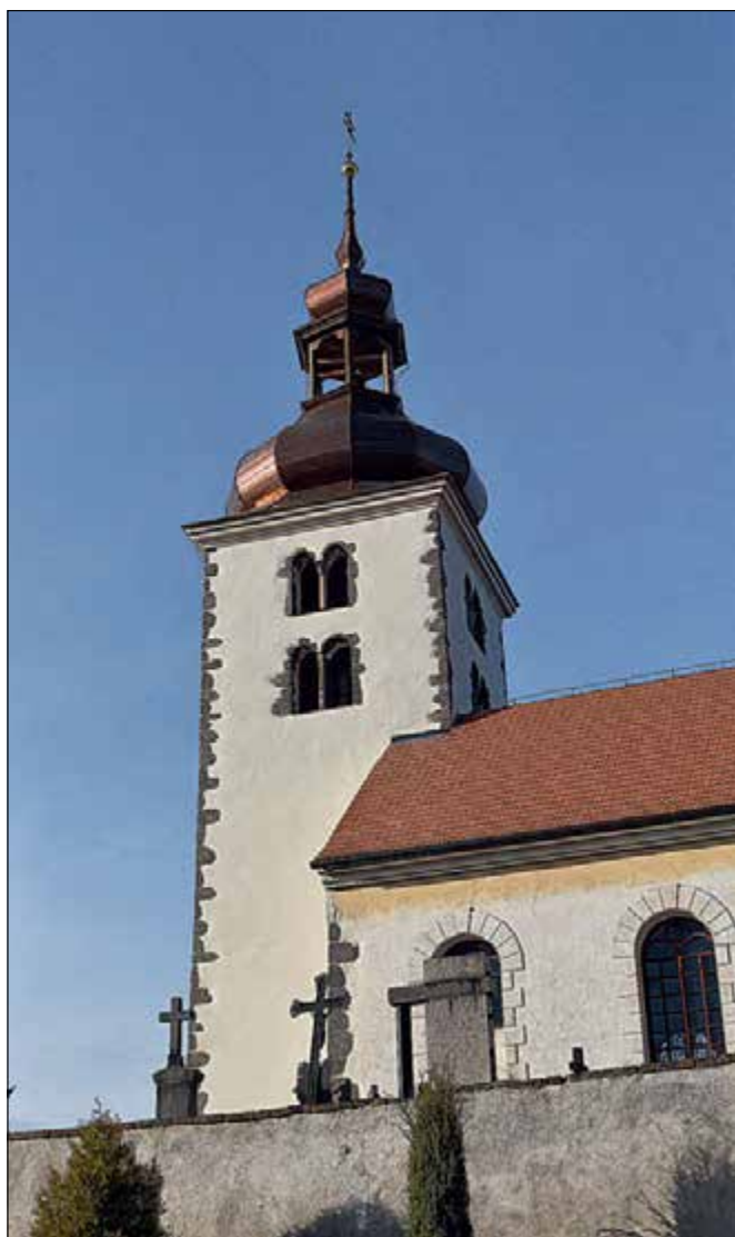
Olbramovice (správní obvod obce Votice), kostel Všechných svatých, celková obnova věže. Krov bání věže musel být pro špatný technický stav zcela odstraněn a nahrazen kopií. Následně byla provedena nová krytina z měděného plechu. Obnova věže byla dokončena opravou a nátěrem vnějších omítek (foto D. Primusová).
