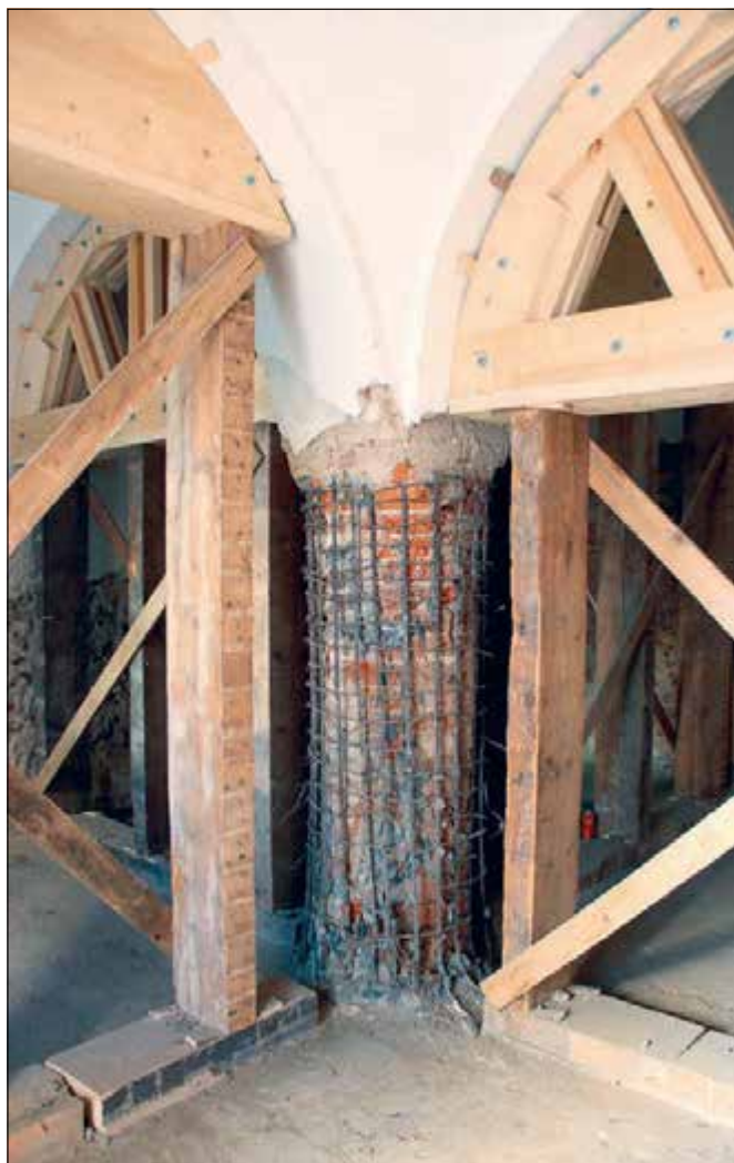
Kutná Hora (správní obvod obce Kutná Hora), Sankturinovský dům čp. 377. V uvedeném období byla započata celková obnova tohoto významného městského paláce pro účely zázemí Galerie Felixe Jeneweina v Kutné Hoře. Do adaptace je zahrnut také patrový dvorní objekt, jehož klenba nesená středním sloupem byla v sedmdesátých letech minulého století sanována pomocí železobetonu. Havarijní sloup musel být v roce 2021 řešen podepřením kleneb, odstraněním pilíře a jeho náhradou (foto A. Pospíšil).
