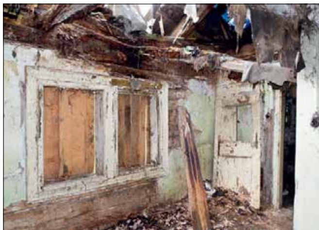
Bělá pod Bezdězem (okres Mladá Boleslav), Berkova čp. 267 – Stav barokně-klasicistního roubeného domu byl do té míry havarijní, že realisticky bylo možno uvažovat jen o demolici a náhradě replikou. V této situaci ale do objektu běžně ještě vstupují památkáři, aby mimo jiné provedli odpovídající a obvykle poslední průzkum, dokumentaci a stavebně historický rozbor stavby (foto V. Jesenský).
