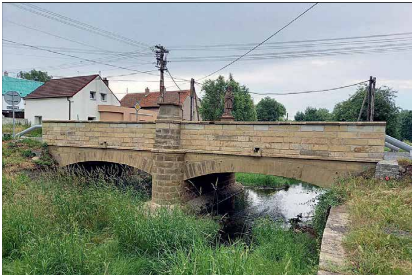
Tmaň (správní obvod obce Slaný), most přes Zlonický potok, stav po dokončení prací. Červen 2021 (foto O. Hrdlička).
