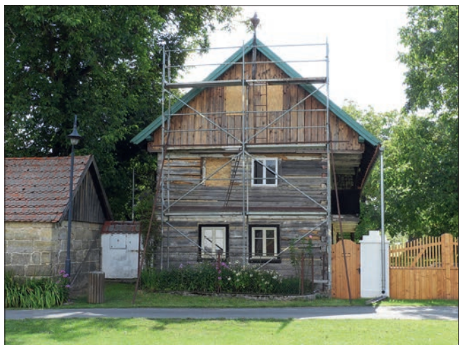
Víska (správní obvod obce Mladá Boleslav), VPR. Dům usedlosti čp. 7 – stav hlavního průčelí před zahájením obnovy, jejímž cílem byla rehabilitace stavu z roku 1921, kdy došlo k výrazné změně podoby průčelí v souvislosti s výměnou krovy a krytiny (foto J. Berková).
