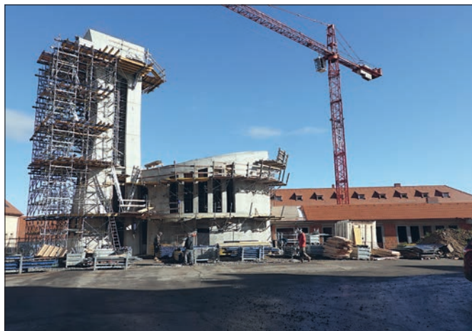
Drasty (správní obvod obce Brandýs nad Labem – Stará Boleslav), pohled na rozestavěný konvent bosých karmelitánek s kostelem, který vznikl proměnou hospodářského dvora se zámečkem (říjen 2022). V pozadí vystupuje střecha hlavního křídla konventu – stavebně upravené stáje se sýpkovým patrem z 20. let 19. století (foto J. Žižka).
