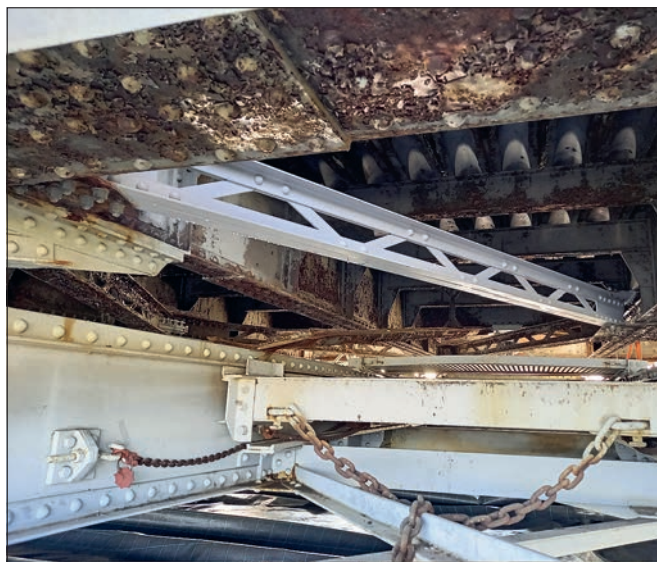
Miřejovice (správní obvod obce Kralupy nad Vltavou), most přes Vltavu, stav po dokončení opravy dolní části mostovky, červen 2022 (foto O. Hrdlička).
