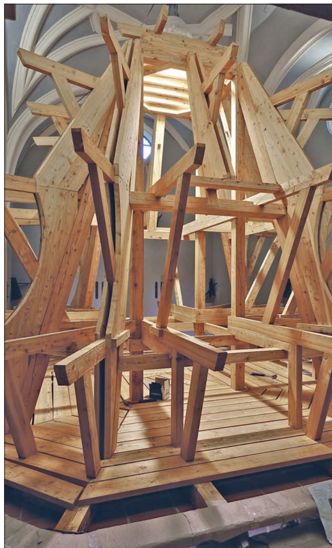
Kutná Hora – Sedlec (správní obvod Kutná Hora), kaple Věch svatých s kostnicí. Po předcházející stavební obnově uvnitřního prostoru severozápadního pole ossaria došlo v průběhu roku 2022 k výstavbě kosterní pyramidy. Základem je tesařská konstrukce z modřínového a dubového dřeva, ve které spočine přibližně sedm metrů krychlových kosterních pozůstatků, které prošly mechanickou kontrolou a dezinfekcí. Zbývá část objemu bude tvořena dutinami umožňujícími provětrávání konstrukce pyramidy i případnou kontrolu jejich stavu v budoucnosti (foto A. Pospíšil).
