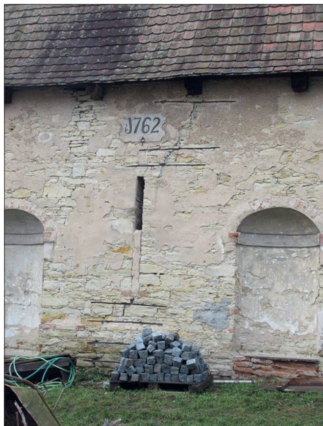
Lysá nad Labem (správní obvod obce Lysá nad Labem), stodola v areálu fary čp. 7, pohled na východní obvodovou zeď s výklenky a s datací 1762 po statickém zajištění svislé trhliny vodorovnými helikálními výztužemi.
