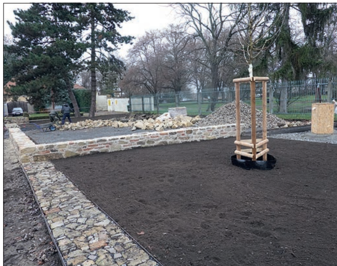
Brandýs nad Labem (správní obvod obce Brandýs nad Labem – Stará Boleslav), úpravy tzv. Plantáže na předzámčí. Zdivo a dlážděné pásy naznačují barokní budovy předzámčí zbořené na počátku 60. let 20. století. Šířku zdiva ověřil archeologický sondážní průzkum, struktura zdiva z místního kamene byla vyzkoušena na vzorcích (foto J. Žižka).
