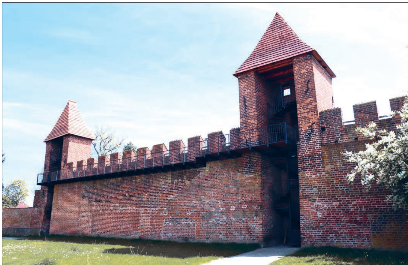
Nymburk (správní obvod obce Nymburk), městské opevnění: Pohled na úsek hradby v lokalitě Na Rejdišti, kde bylo v roce 2022 realizováno nejprve zpřístupnění dvou věží a mezilehlého pole pomocí točitých schodišť spojených ochozem a následně oprava střech obou těchto věží. Nově vložené konstrukce schodišť a ochozu byly navrženy tak, aby zásahy do zdiva byly minimální. Nosníky ochozu byly vsazeny do kapes, které ve zdi navrhl a nechal zhotovit při rekonstrukci na počátku 20. století stavitel Ludvík Labler pro jím zamýšlený, avšak nerealizovaný dřevěný ochoz. Volba soudobého materiálového provedení byla vedena ani ne tak snahou jasně odlišit další časovou vrstvu, ale spíše dosáhnout co nejsubtilnější, a tedy co nejméně rušivé konstrukce. Domníváme se, že i přes složitý průběh prací bylo tohoto záměru nakonec dosaženo (foto B. Schmidová).
