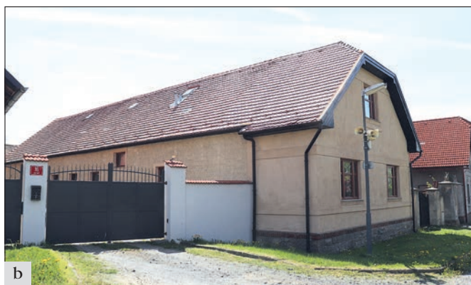
Svatbín (správní obvod obce Říčany), OP, dům čp. 35: a – doživající rezná prvorepubliková fasáda z probarveného štuk; b – při opravě fasády bylo původní řešení respektováno, probarvený štuk dodala firma Premix. Absenci nátěru bylo možné zachovat přirozený vzhled, zejména charakteristickou živost povrchu (foto J. Černochová).
