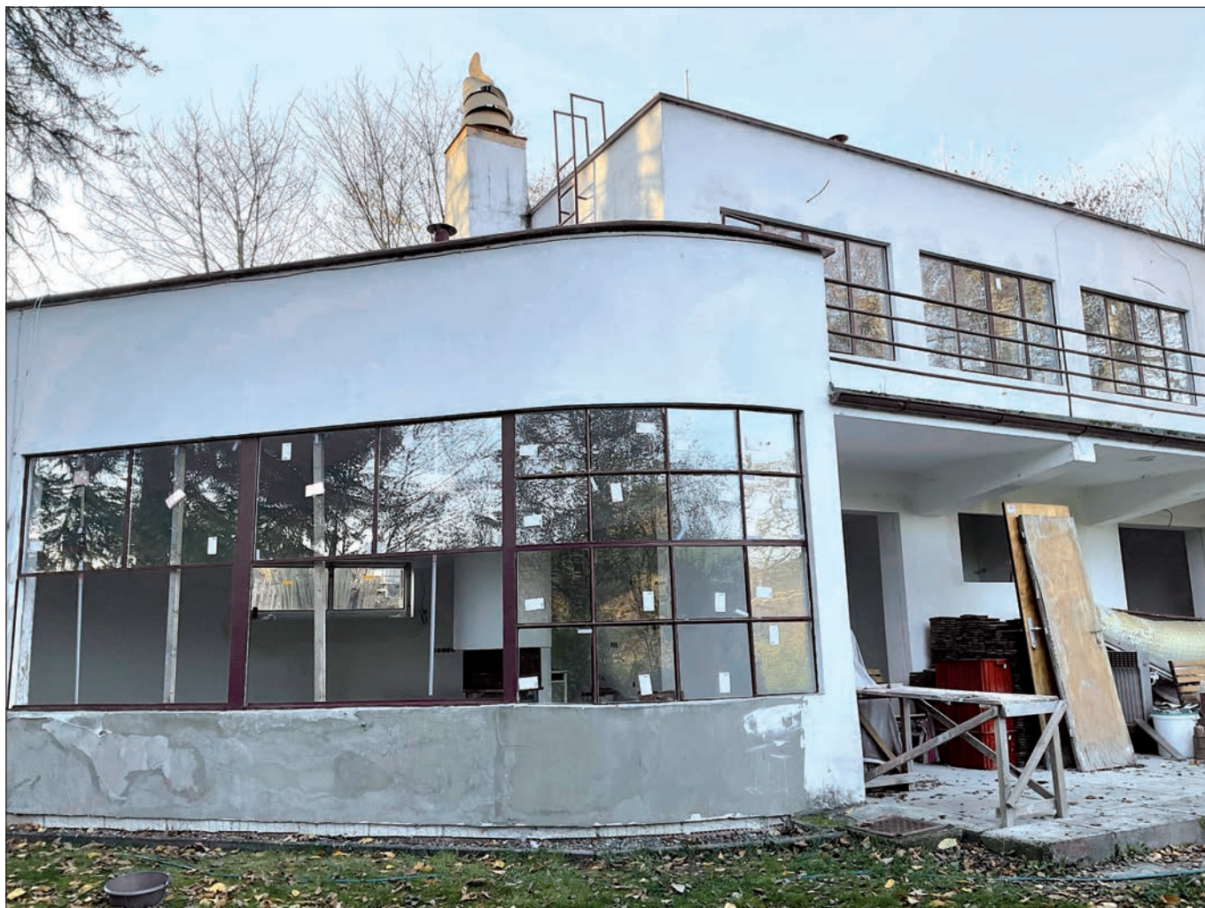
Sázava (správní obvod obce Benešov), letní vila, čp. 177. Celková obnova funkcionalistické letní vily pro trvalé bydlení si vyžádala úpravu jednoduše zasklených kovových oken pro zlepšení jejich tepelně technických vlastností. Jejich obnova je prováděna příkladně. Kovové rámy křídel jsou citlivě přerušeny a zesíleny. Do profilu jsou vložena jako izolační výplň tenká izolační dvojskla. Lze konstatovat, že taková úprava je přijatelná a je šancí pro splnění dnešních zvýšených nároků v dalších funkcionalistických budovách (foto D. Primusová).
