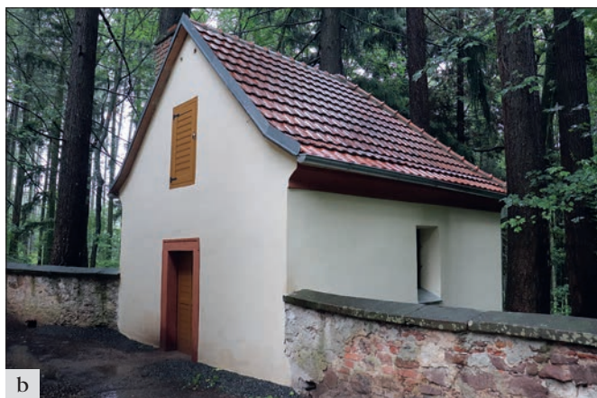
Aldašín (správní obvod obce Říčany), kostel sv. Jiří: a – objekt márnice před obnovou fasád a interiéru; b – objekt po dokončení obnovy. Barevnost fasády byla volena dle barevnosti kostela (foto J. Černochová).
