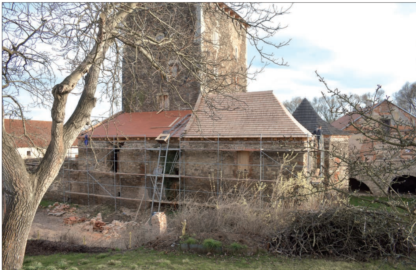
Hradenině (správní obvod ORP Kolín), rekonstrukce zastřešení severních hospodářských objektů tvrze (foto D. Havlíková, stav ke konci roku 2022).
