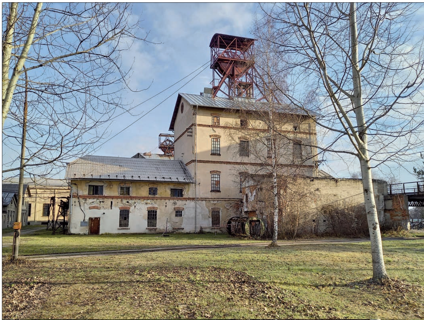
Vinařice (správní obvod obce Kladno), těžní věž Mayrau, stav po dokončení druhé etapy opravy – výměně střešní krytiny, listopad 2022 (foto O. Hrdlička).
