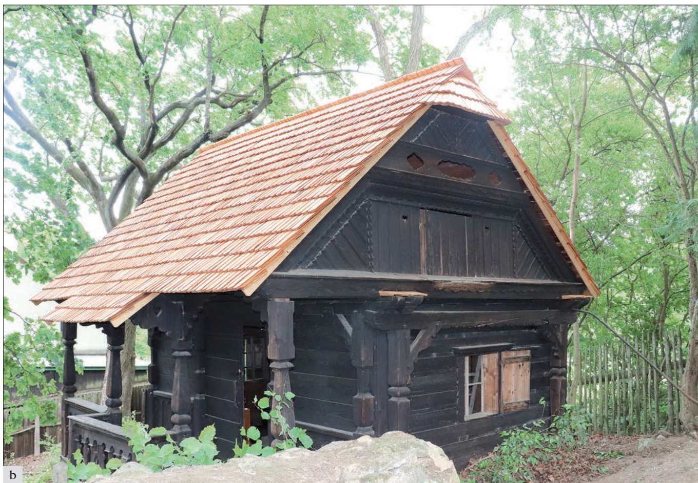
Jevany (správní obvod obce Říčany), areál Fantovy vesnické usedlosti. Výměnek přenesený z Národopisné výstavy československé z roku 1895: a – detail stavu šindelové krytiny před obnovou; b – celkový pohled po obnově střešního pláště (foto M. Hanzlíková).
