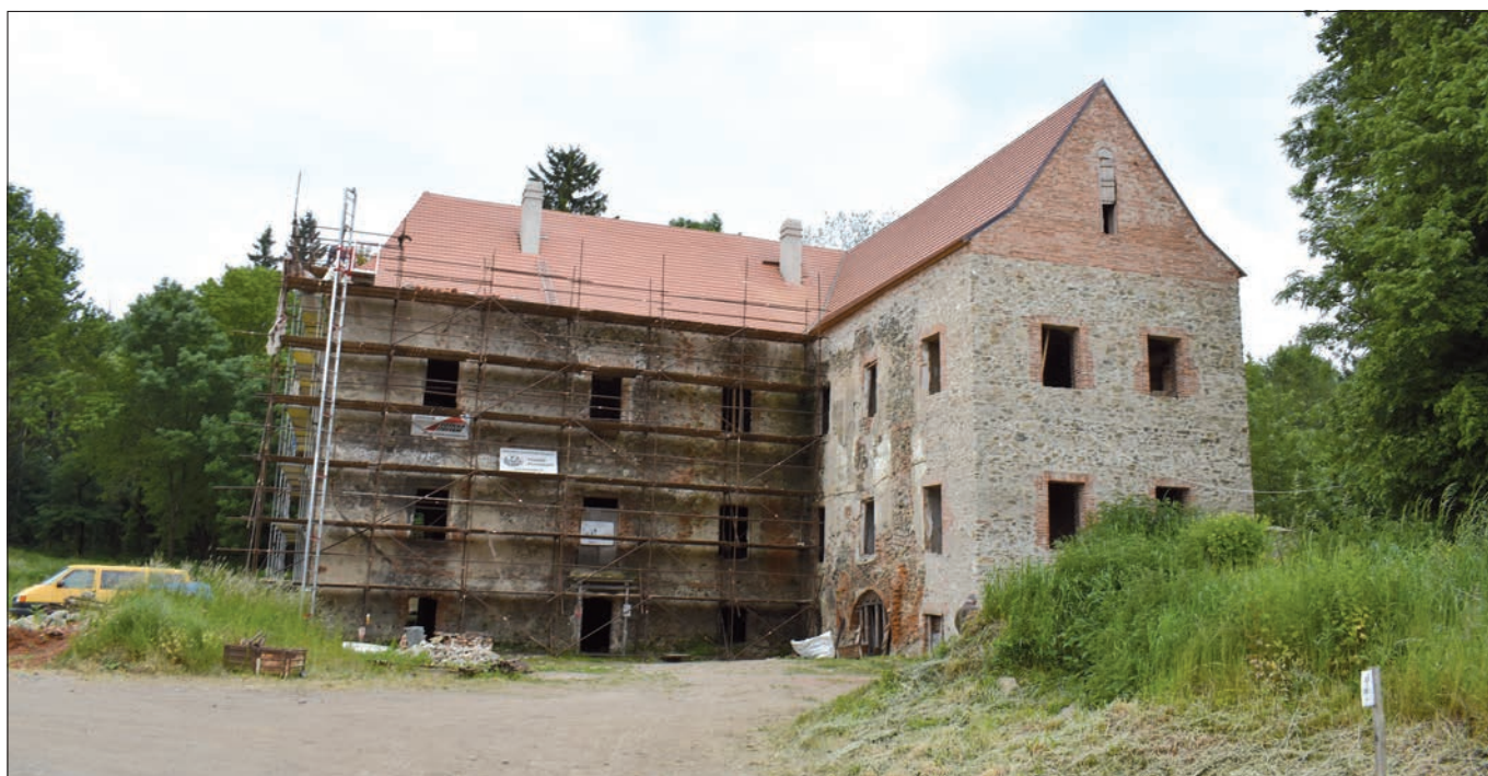
Zvěstov (správní obvod obce Votice), zámek, celková obnova. Po dostavbě západního křídla byla provedena také obnova střechy západního křídla, čímž byl objekt zachráněn před zánikem. (foto D. Primusová).
